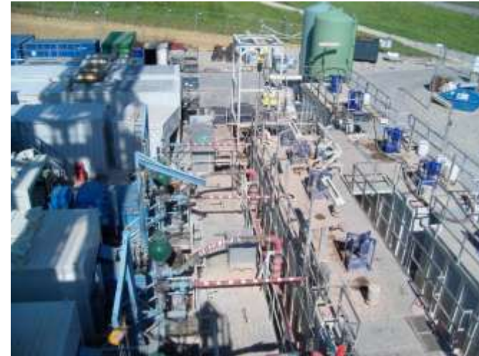
Spülpumpen und -tanks
